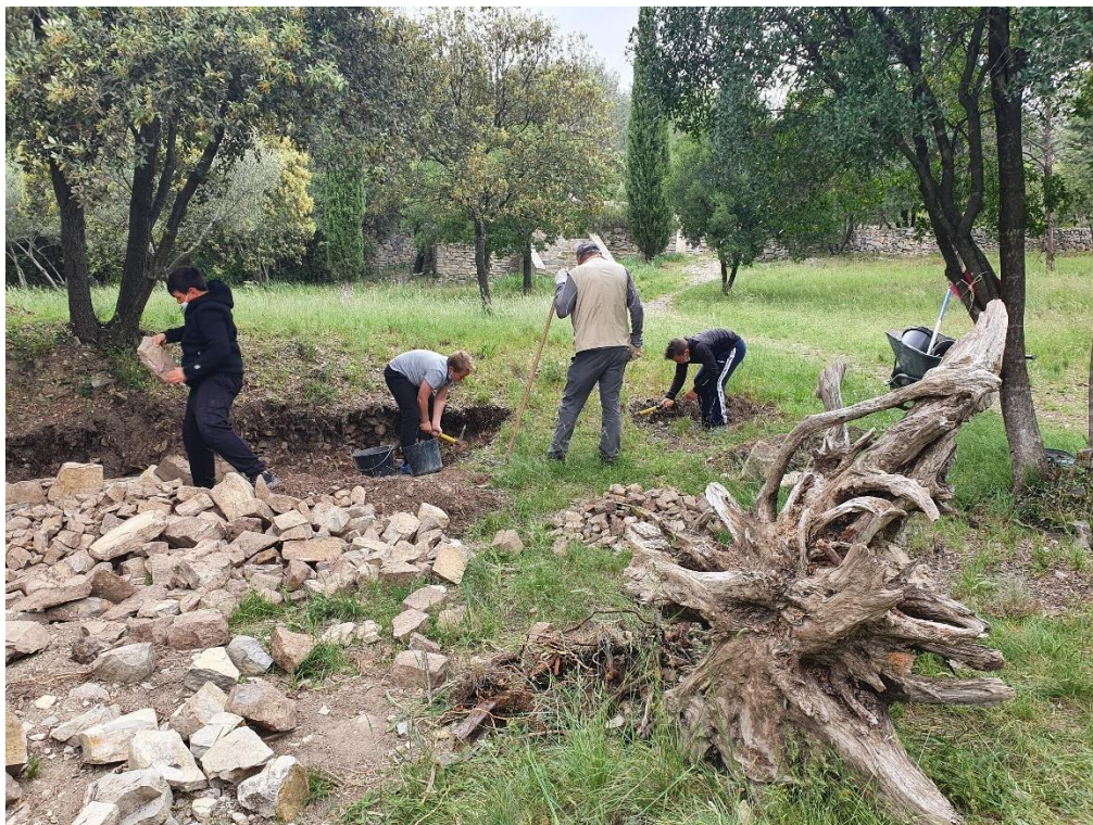
Réfection de murets en pierre sèche en garrigue – convention avec l'Association « Menhirs » 04.2022
